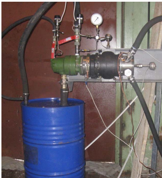
Рис. 4. Турбонасосная установка СРМ
